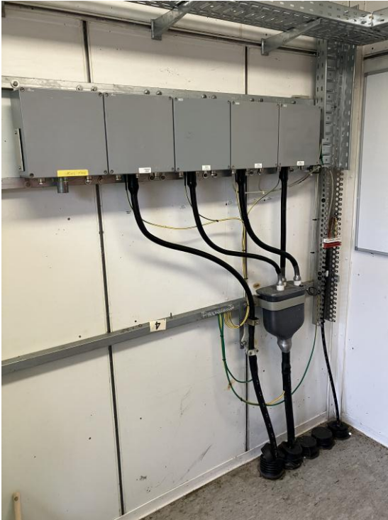
Abbildung 11: Freie Kabeleinführungen für Cu-Kabel
