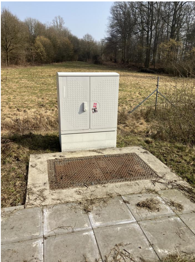
Abbildung 12: Beispiel für eine SST mit Wartungsfläche und KS
