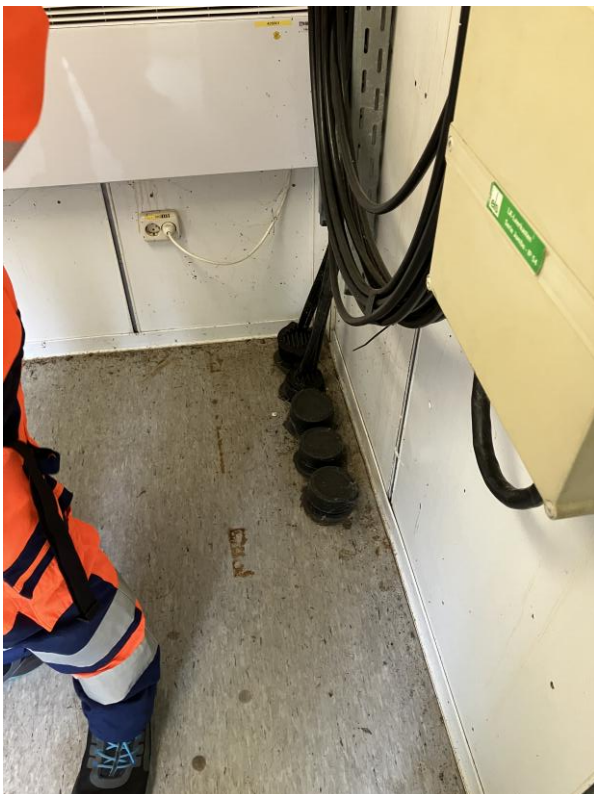
Abbildung 10: Freie Kabeleinführungen für LWL-Kabel
