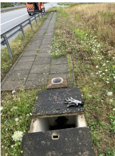
Abbildung 6: geöffneter NRS-Schacht bei km 16.85
